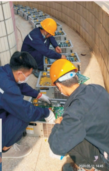
5月11日，花湖水厂生产科组织维修人员及变频设备厂家三名专业技术人员到花湖水厂取水泵房，对变频设备进行除尘维保。由于近期取水量增大，变频器在调高后机体温度瞬间增高，为保证机器安全正常工作，花湖水厂高度重视，及时联系变频设备厂家来为变频器除尘维保。维修人员及技术人员将变频24个功率单元一一拆卸并细心除尘。在维保时发现变频器风机出现排风不畅的故障，对此及时进行了处理。复原调试后变频器温度大幅度降低，设备运行稳定，安全生产得到了保障。
