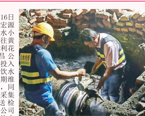
9月16日和27日，宏源公司直饮水小组分别前往黄石港区佰利花园、盛昌公馆，对已投入使用的直饮水机进行定期维护和检修。宏源公司将社区直饮水机检修作为常态化工作持续推进，提升服务质量。（余 活 孙玉珍）
